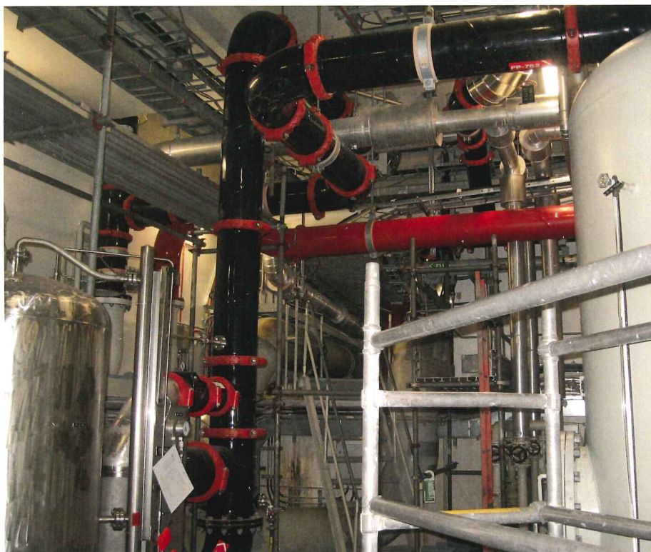
Exempel på brandvatteninstallation med Alveniusrör
